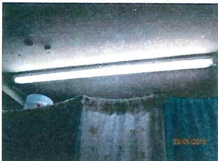
ILUMINACIÓN DE BAÑOS
